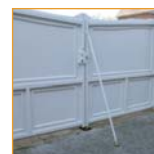
Pour sécuriser en cas de vent fort
